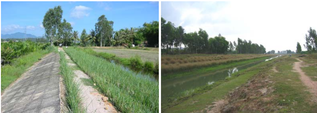
Foto 12: Tanggul anti-salinitas hulu dengan talud beton menghadap sungai (kiri) dan sepanjang satu bagian kanal irigasi, erosi permukaan merusak tepian di ujung lain.
