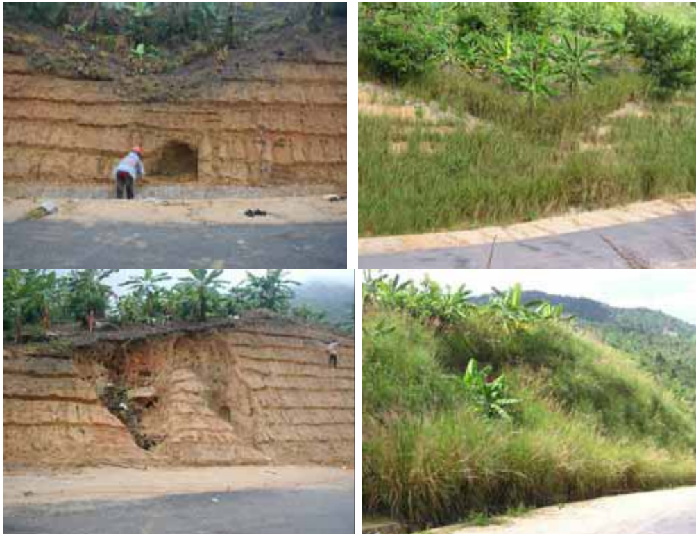
Foto 22: Pham Hong Duc Phuo, proyek perlindungan jalan di propinsi Khanh Hoa, jalan menuju Hon Ba): kiri dua foto: erosi yang parah pada lereng penahan yang baru dibangun yang terjadi hanya setelah beberapa kali hujan; kanan dua foto: delapan bulan sesudah penanaman Vetiver: Vetiver menstabilkan lereng ini, benar-benar menghentikan dan mencegah erosi lebih lanjut di musim hujan berikutnya.
