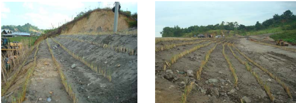
Foto 20 : 100.000 slip vetiver ditanam untuk menstabilkan tanah liat dan tanah serpih untuk melindungi lereng dan jalan akses sebelum pembangunan kontruksi perumahan yang sangat besar ini
