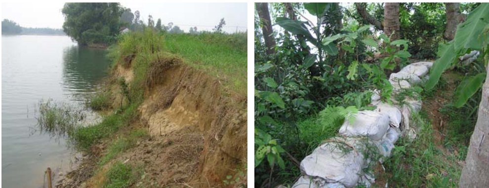
Foto 13: Kiri: tepi sungai Tra Khuc yang tererosi parah, di Binh Toi Commune; kanan: perlindungan kantung pasir
